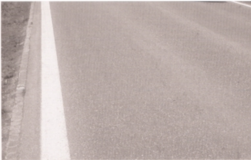
Lenzburg-Wohlen, Struktur der Trinidad-Teststrecke nach 28 Jahren
